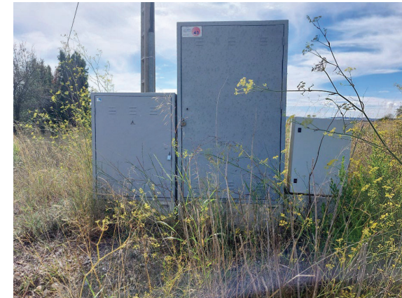
Figura 6. Quadre elèctric existent per les instal·lacions d'ITS de carreteres.
